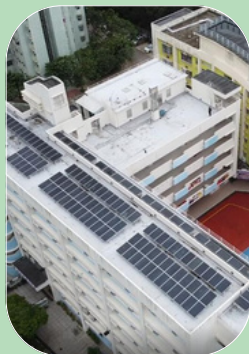
196塊太陽能 發電系統
