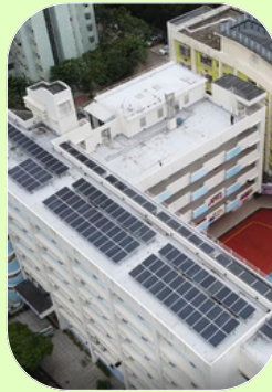
196塊太陽能 發電系統
